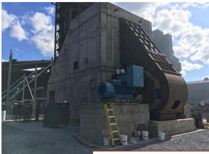
Dépoussiéreur de la hotte de toit de Contreccœur-Ouest
